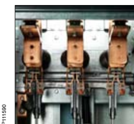
Letmanøvrerede jordingskoblere og tilslutningsfaner forstærker sikkerheden.
